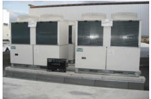
二酸化炭素冷媒冷凍機
