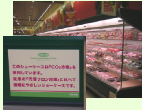
スーパーマーケットの二酸化炭素冷媒ショーケース
