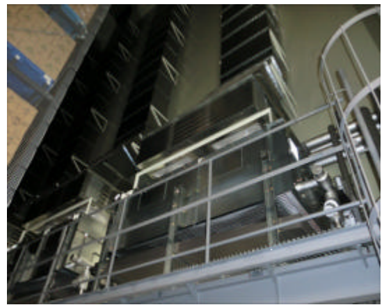
冷蔵倉庫内機器
