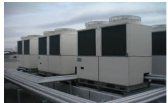
二酸化炭素冷媒冷凍機
