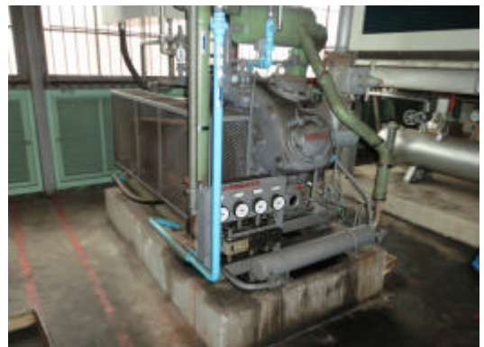
アンモニア冷凍機
