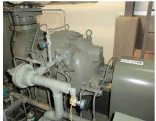
アンモニア冷凍機
