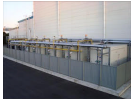
アンモニア / 二酸化炭素冷凍機ユニット
