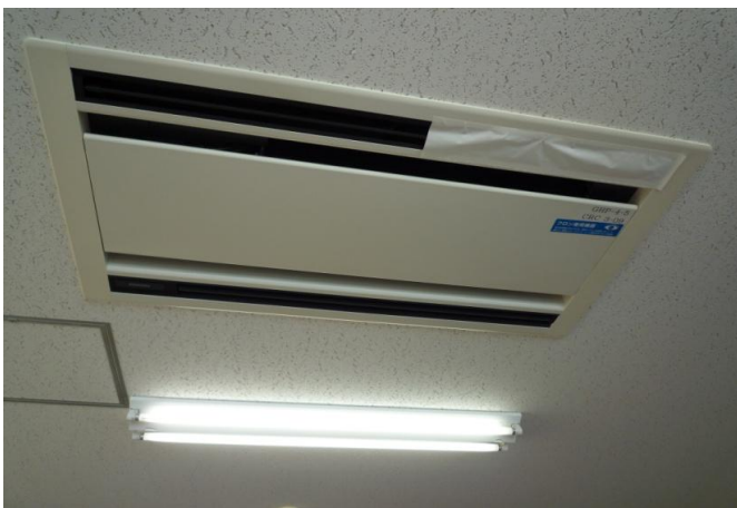
天井埋込室内機
