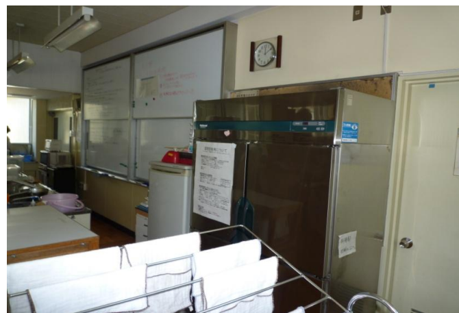
実習室冷凍冷蔵機
