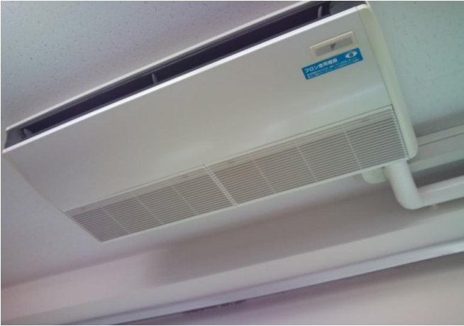
職員室室内機
