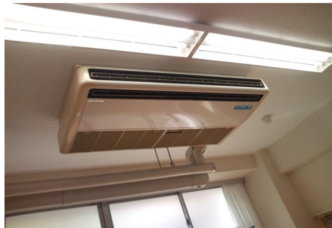
保健室室内機
