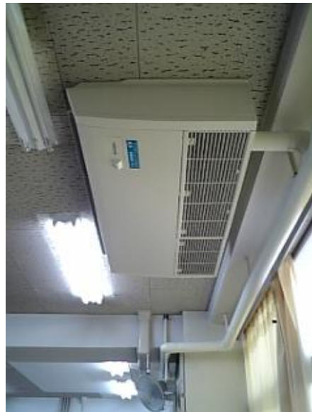
天井吊室内機
