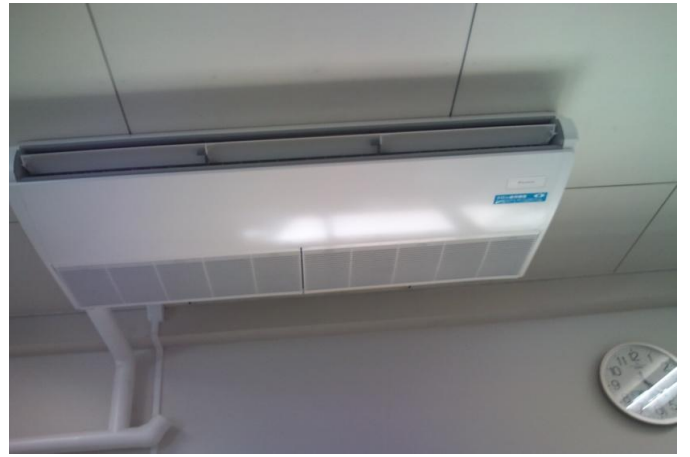
応接室室内機
