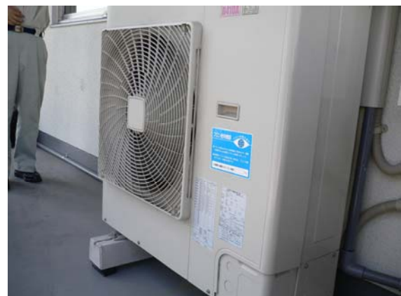
【業務用エアコンへのシール貼付例】
