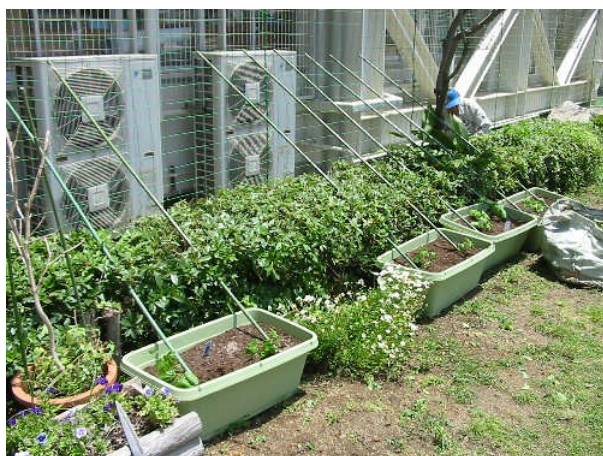
校舎と花壇の間にある室外機
