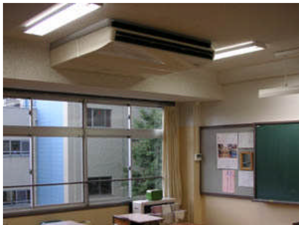
教室内のエアコン
