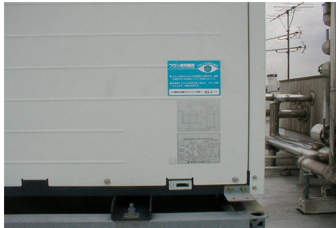
太平エンジニアリング 名古屋支店 GHPエアコン
