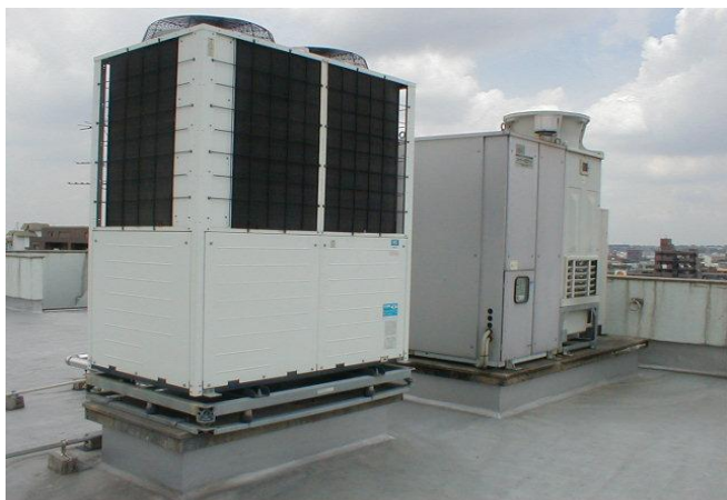
太平エンジニアリング 名古屋支店 GHPエアコン
