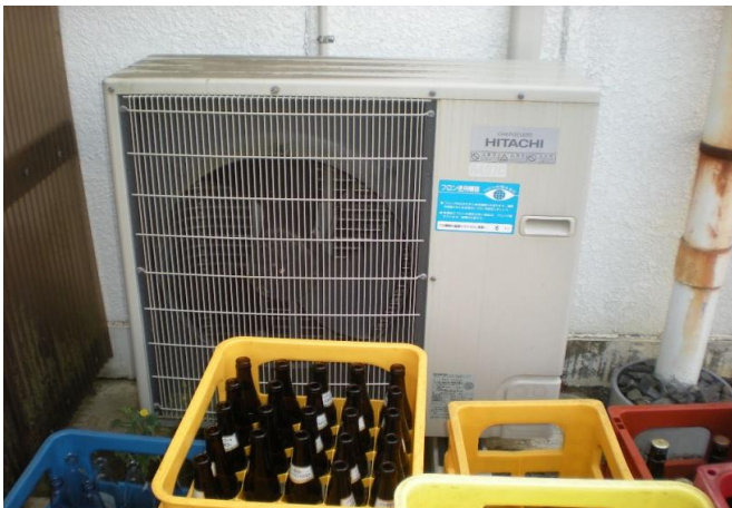
店舗事務所 室外機
