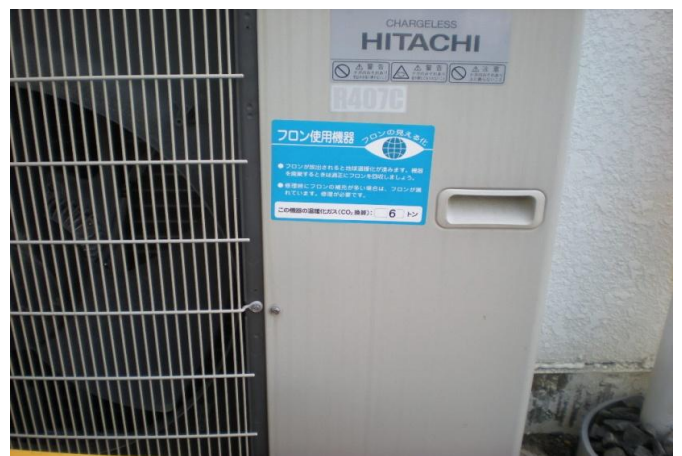
店舗事務所 室外機
