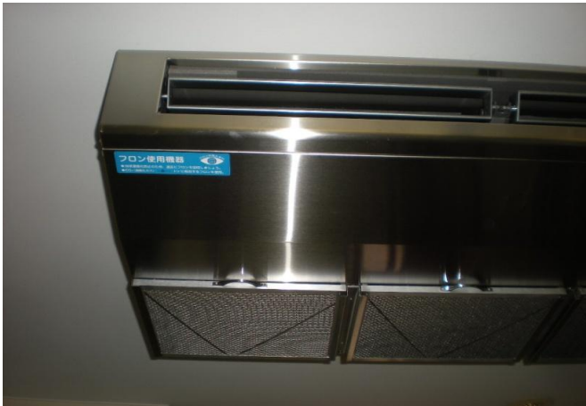
葬儀場厨房(天井パッケージ) 室内機
