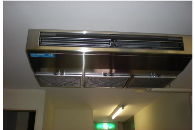
葬儀場厨房(天井パッケージ) 室内機
