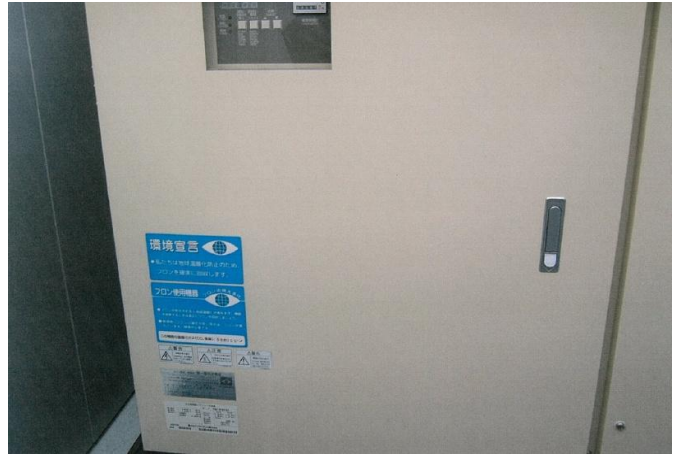
スクリュー冷凍機 55kw
