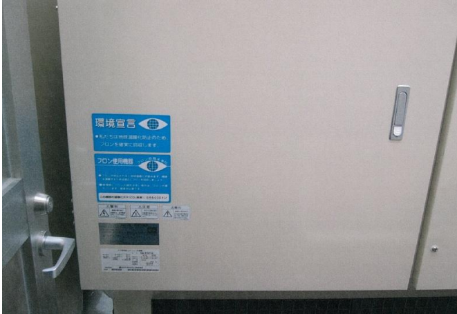
大和冷熱工業 スクリュー冷凍機 55kw
