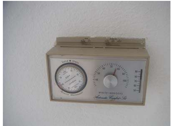
セントラル冷暖房の温度設定パネル
