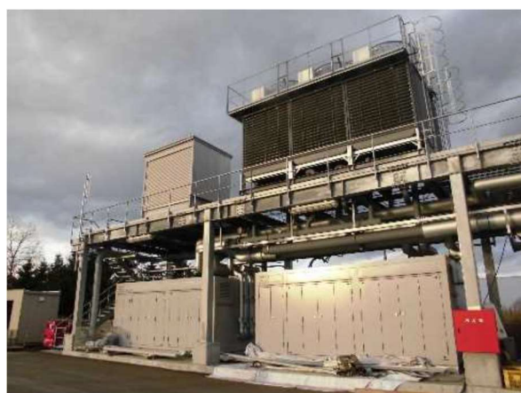
図-3 工場敷地内に設置された NH3/CO2 二元圧縮式冷凍機 (架台下) 及び 冷却塔と NH3 除害装置 (架台上) の例
