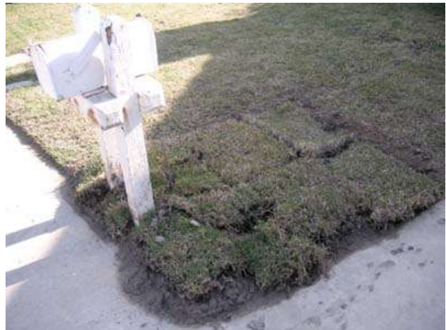
穴を掘ってから、ポストを埋め直したが、工事がいい加減なのでポストの高さがだいぶ低くなってしまった。
