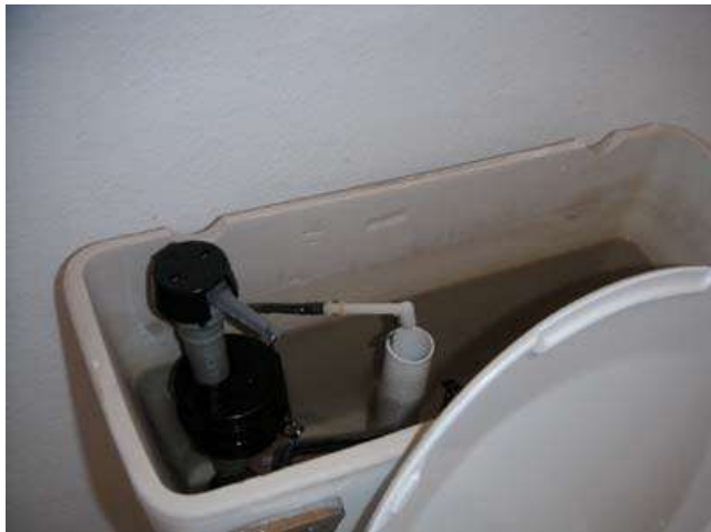
壊れた水洗トイレのタンク
