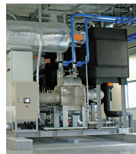
超低温冷凍倉庫に導入された空気冷凍システム
