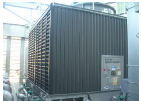
水冷CO 2 冷凍機
