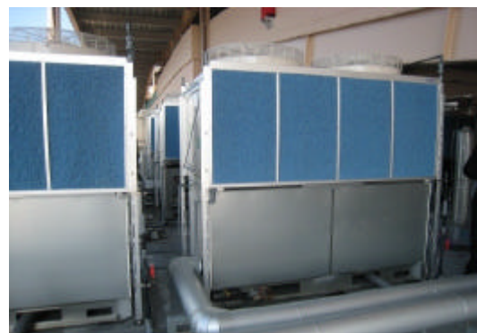
冷凍装置 CO 2 冷凍装置
