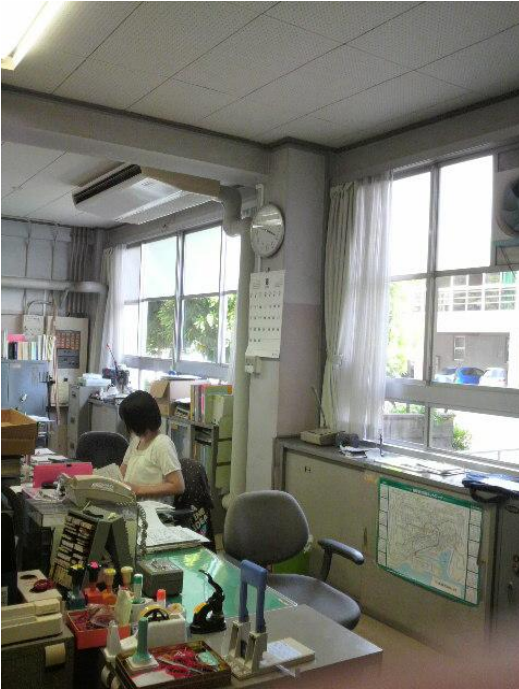
天井吊室内機
