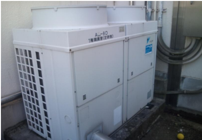
校舎裏室外機
