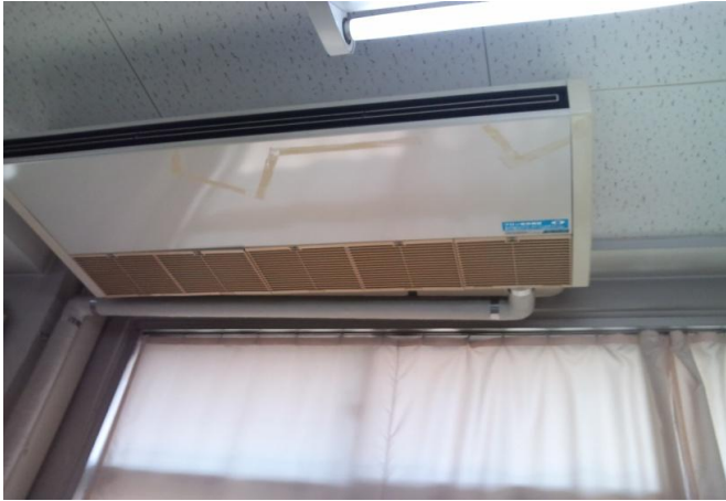
天井吊室内機
