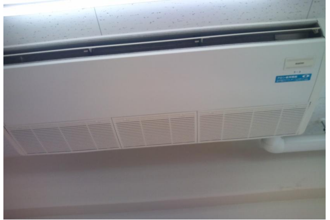
天井吊室内機
