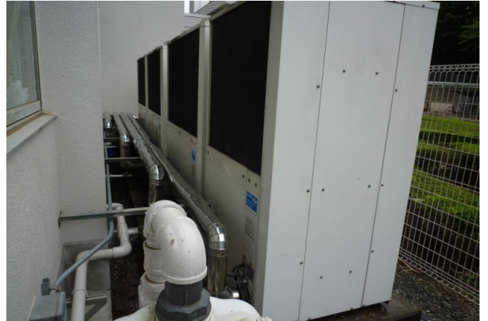
1階校舎裏室外機
