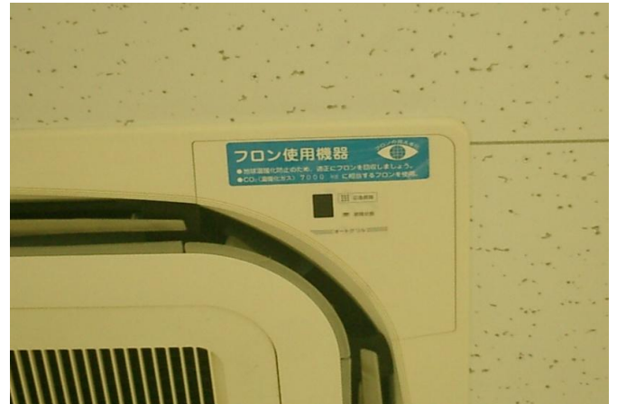
天井埋込室内機
