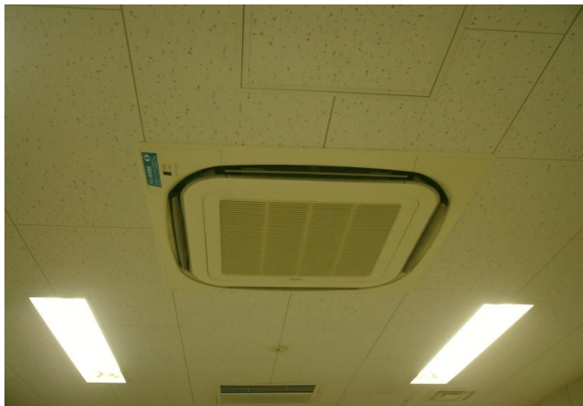
天井埋込室内機
